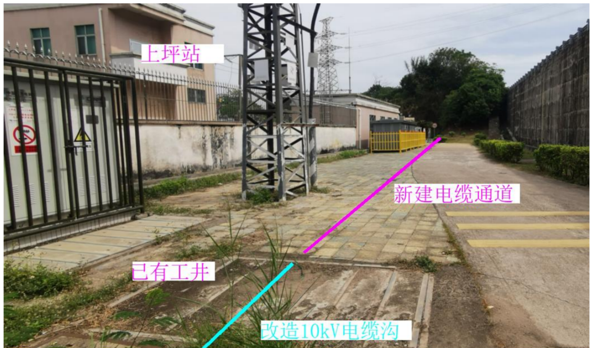
110kV上坪站侧现场照片
