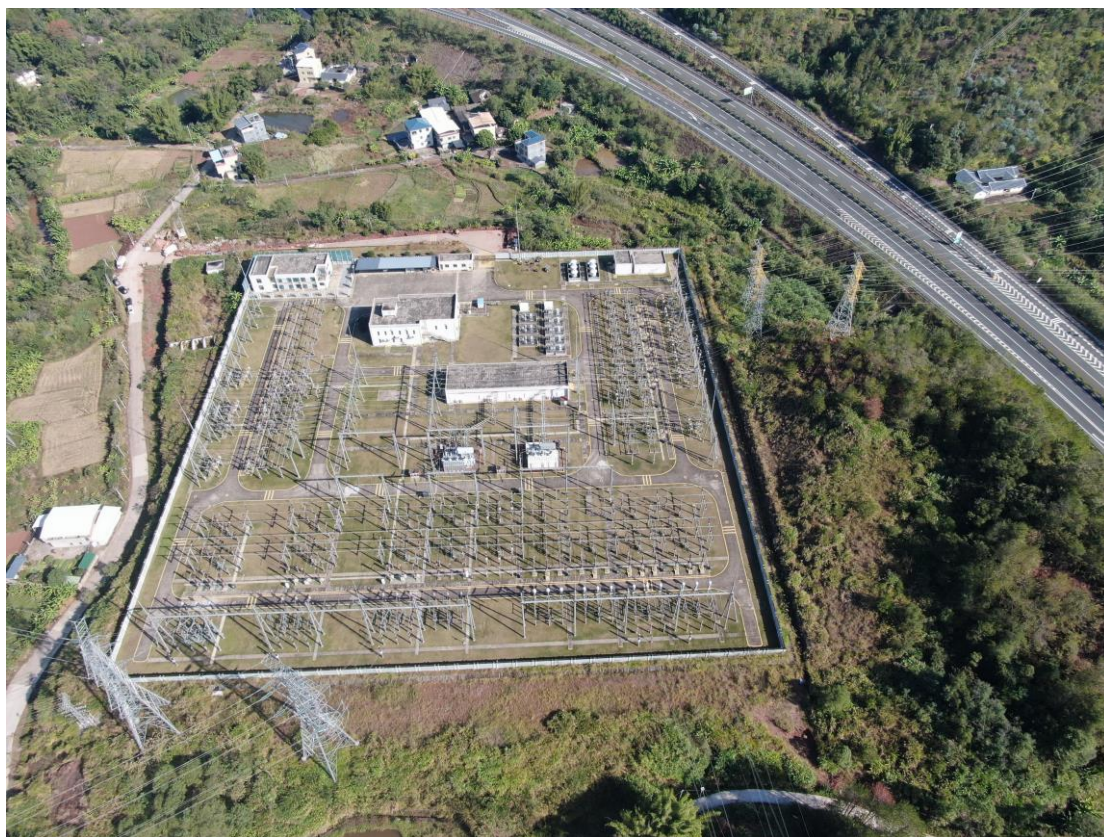
220kV 富远站现状
